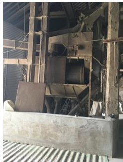
Séchoir à recirculation du grain dans les Ardennes (08)
